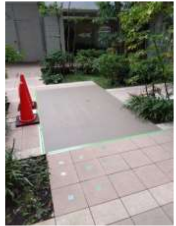
タイル割れの応急手当 エレベーター側から見た中庭
