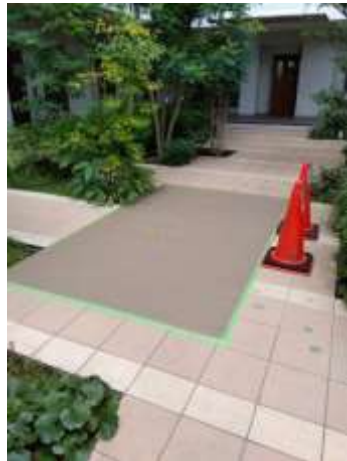
タイル割れの応急手当 ごみ置き場方向からの中庭
