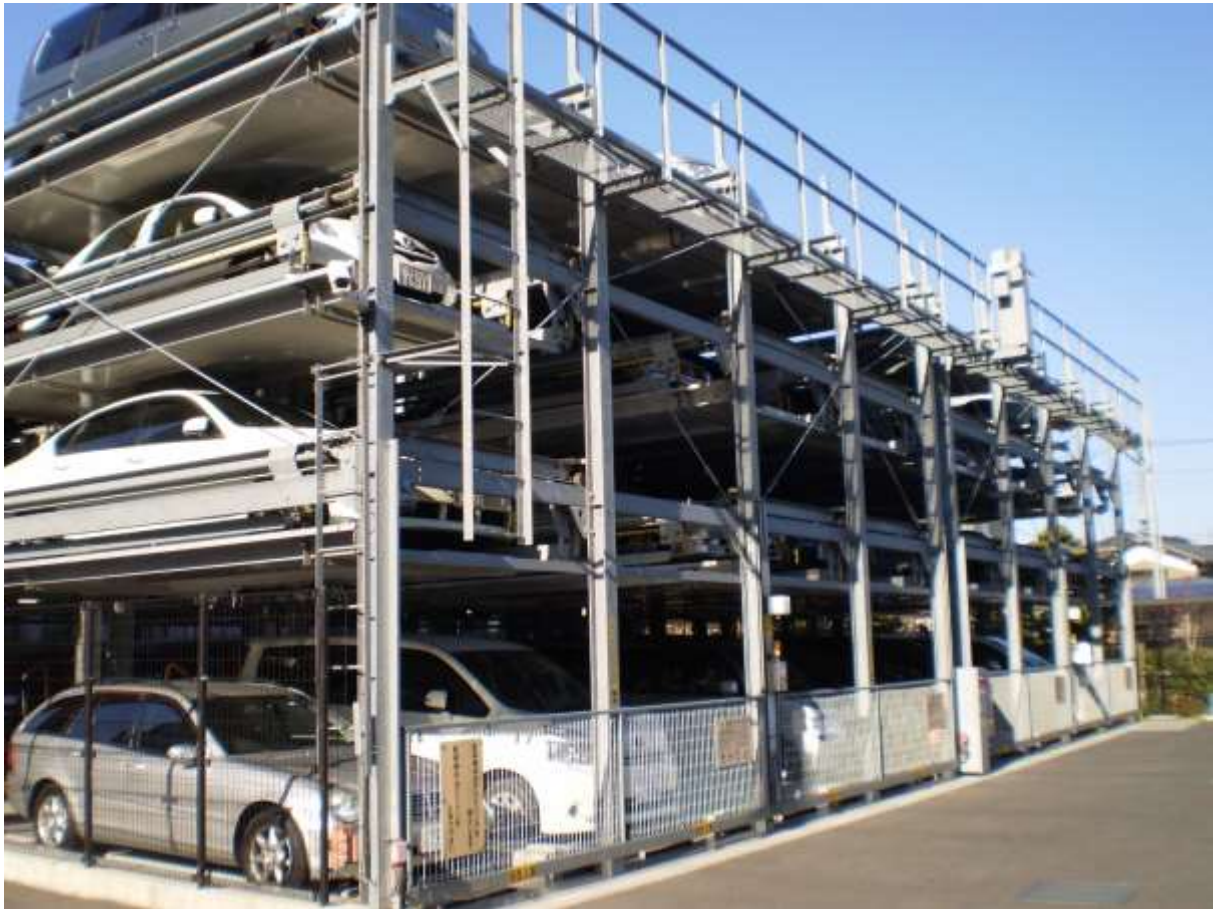
機械式立体駐車機
