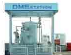
DME充填ステーション 第2種製造設備 (川崎市川崎区南津田町 THINK川崎内)
