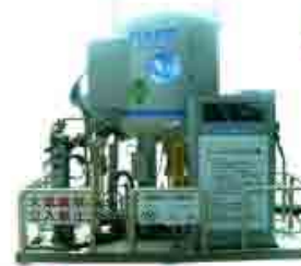
DME充填ステーション 第2種製造設備 (橋本市鶴見区安谷町 興ニヤクコーポレーション内)
