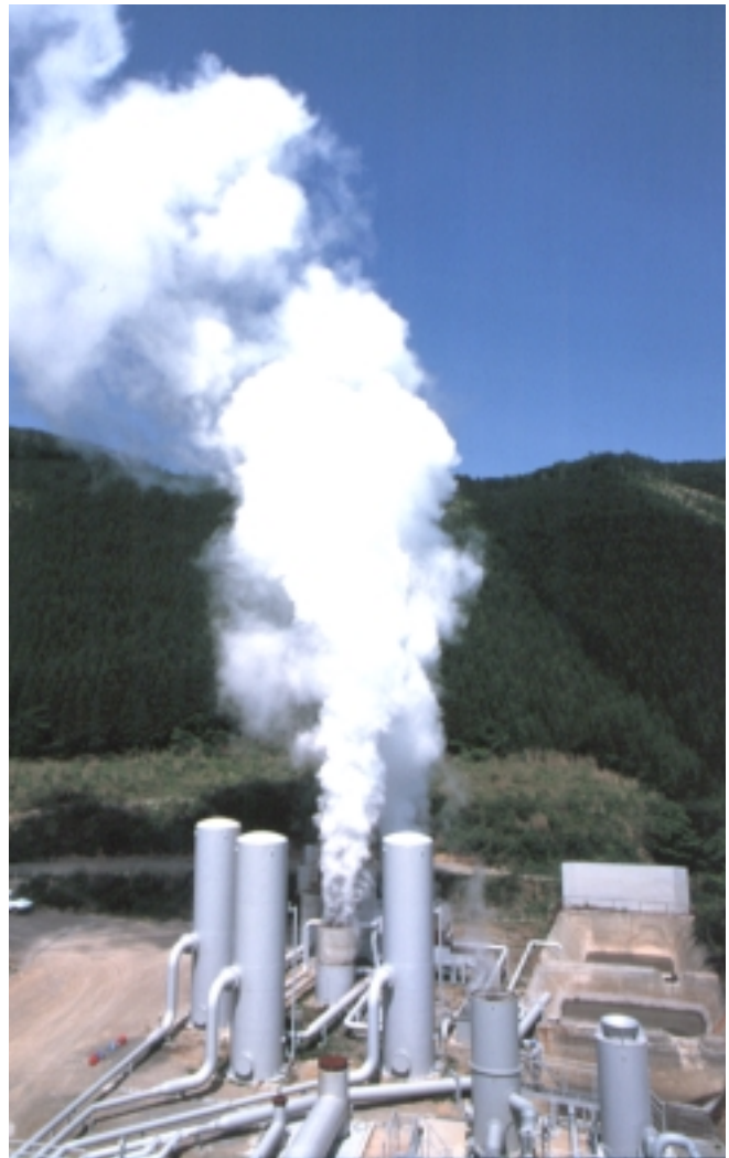
25,000kWに相当する蒸気を電力会社に供給している大分県滝上での地熱開発（会社名：出光大分地熱株式会社）
