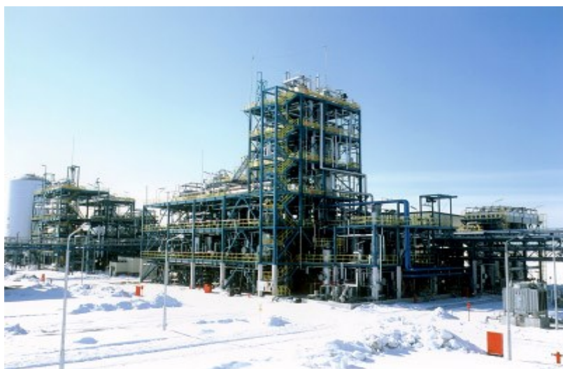
日産 100 トン直接合成実証プラント
