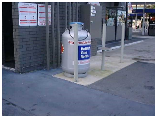
（写真4） 貯蔵燃料ボンベ（容器）
